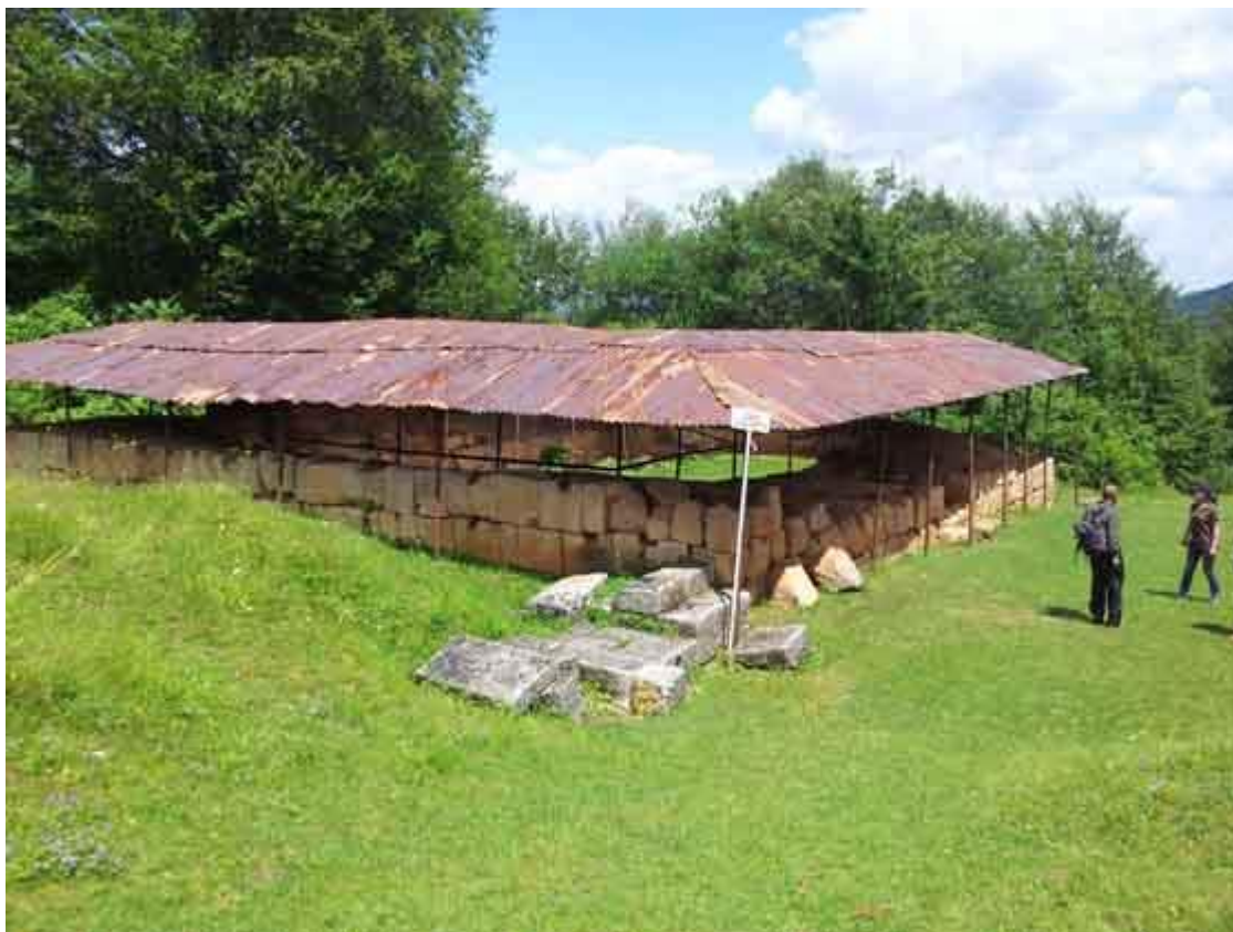
Sistem de protecție temporară existent din anii 80, în stare de colaps
